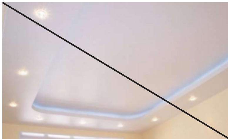
Плохо Многоуровневые гипсокартонные конструкции
